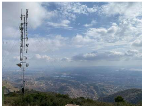
Estación meteorológica instalada en La Vella
